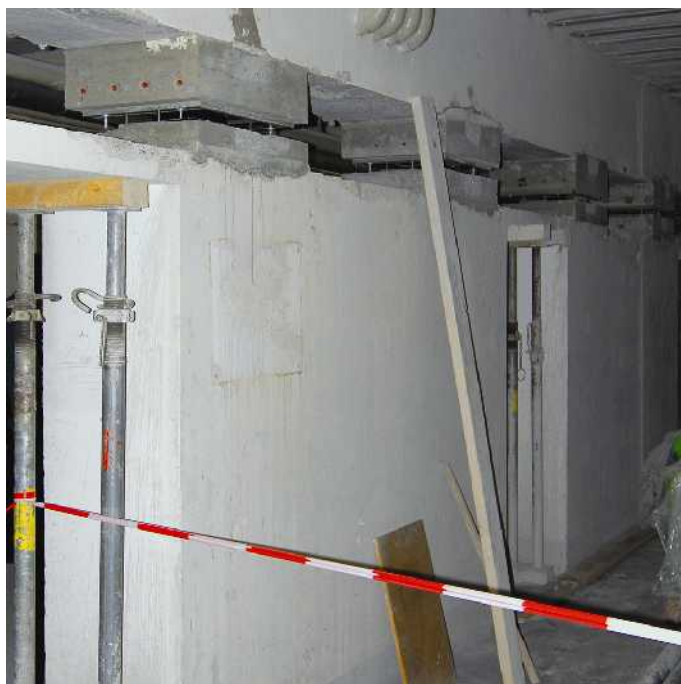
بالشک‌های لغزشی در زیرستون‌های آزاد در وجه داخلی زیرزمین نصب شده‌اند.
