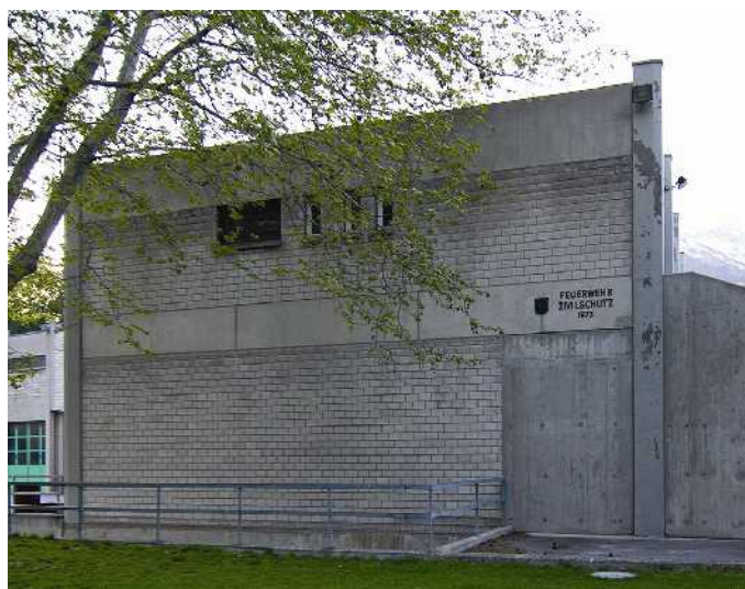
دیوارهای گوشه ساختمان که با نوارهای قائم CFRC تقویت شده‌اند.
