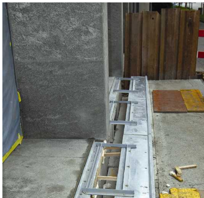
تعییه درز انبساط در اطراف ساختمان حرکت افقی بالیستک‌های لرزه‌ای جدید را ممکن ساخت.
