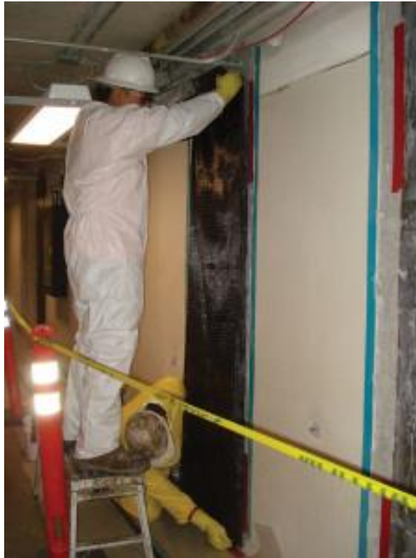
شکل ۱. فضای کاری محدود هنگام نصب FRP
