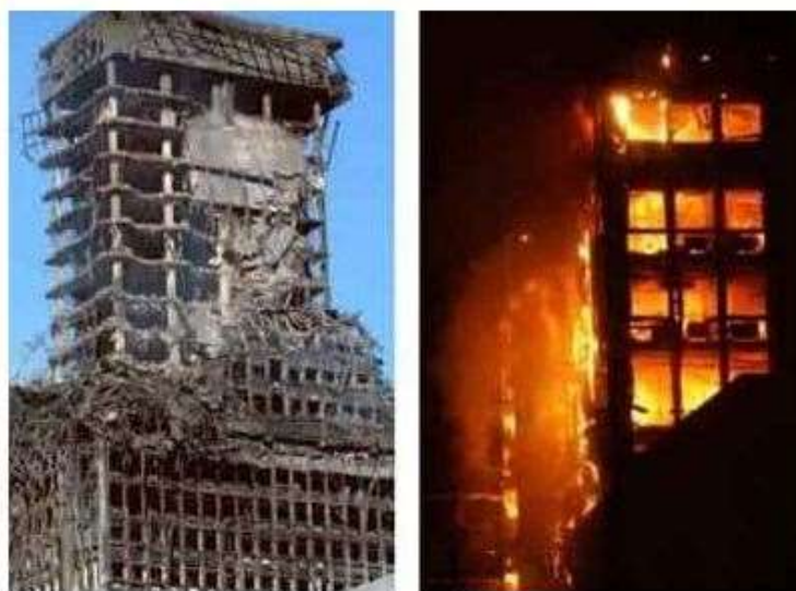
شکل ۴: سازه‌ی بتن مسلح که متحمل حریق وسیعی شده و همچنان پایدار مانده است.
