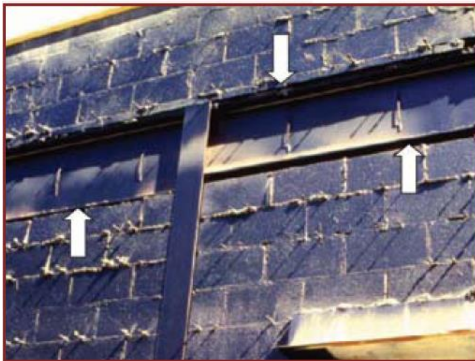
شکل ۱۱: محافظت تیرهای فولادی در برابر رطوبت. جزئیات بندی ضعیف - عدم وجود محافظ آب بند منجر به نفوذ آب می‌گردد.
