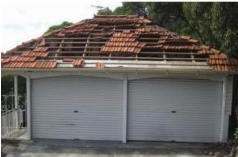
بعضی از سقف‌های مسکونی در زلزله فوریه ۲۰۱۱ با ریزش تعداد زیادی از تایل‌ها روبرو شدند
