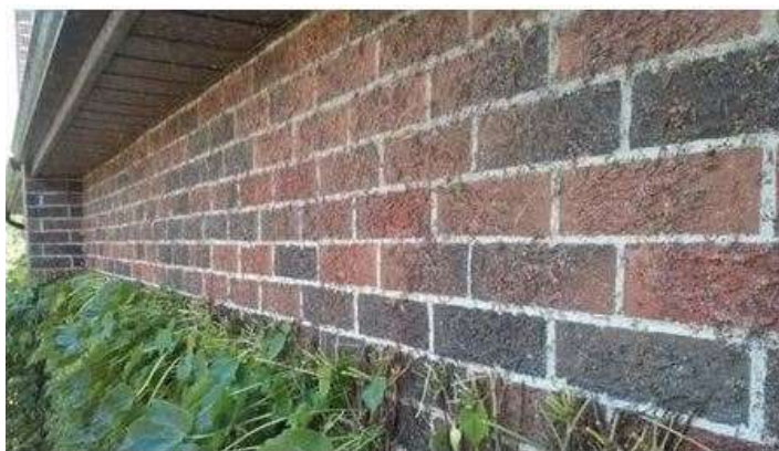
شکل ۵. پیچک بر روی سطح دیوار بنایی آجری
