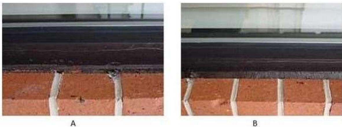
شکل ۳. (A) آب‌بند آسیب‌دیده بین مصالح بنایی آجری و قاب بادی، (B) درزگیر نصب شده‌ی جدید
